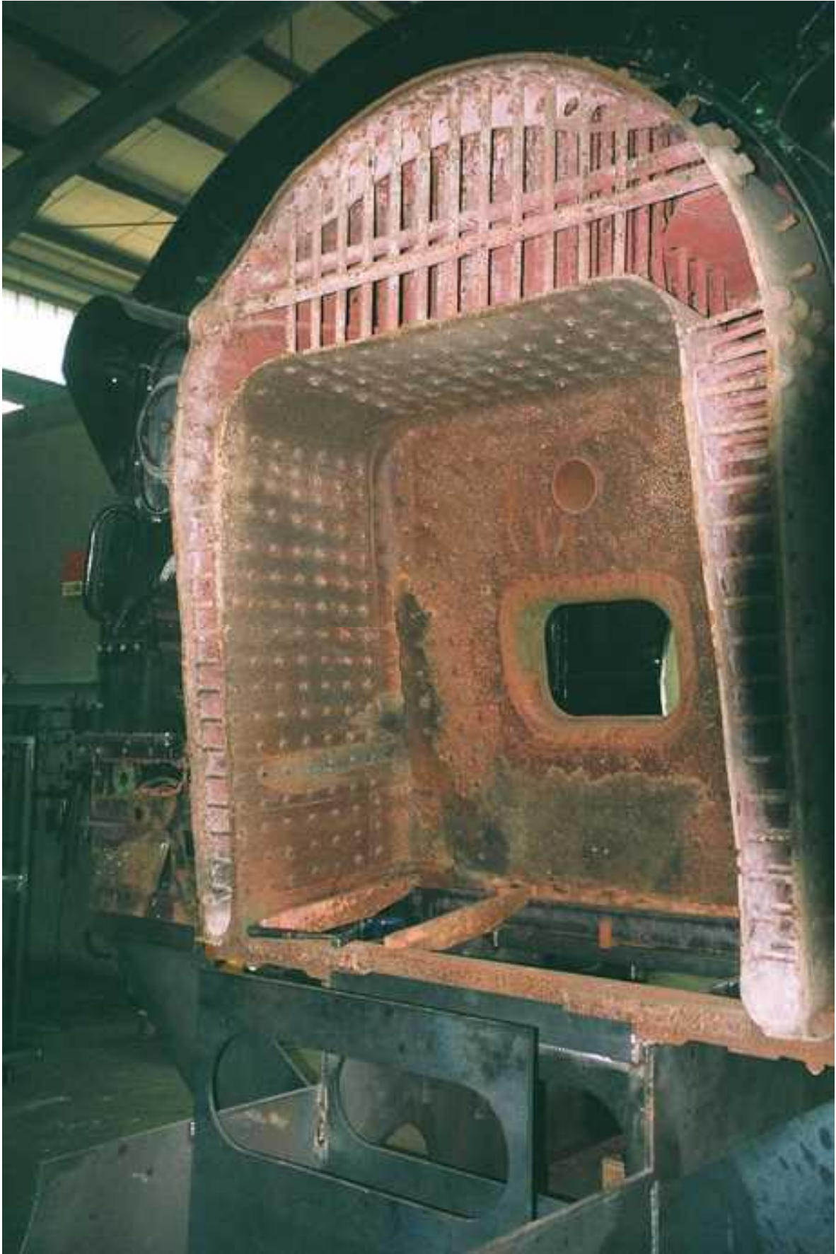
Der Stehkessel mit Feuerloch
