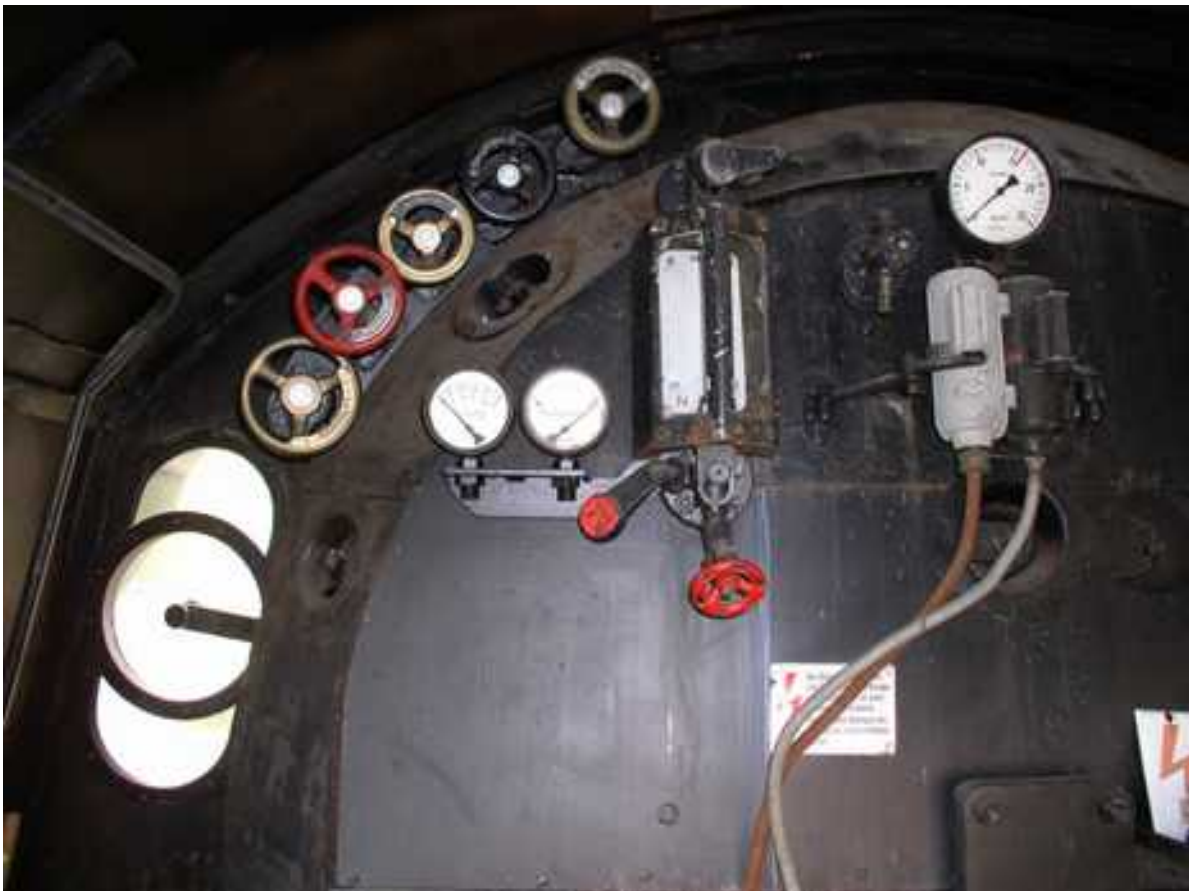
Heizerseite mit Manometern, Handrädern und Wasserstand
