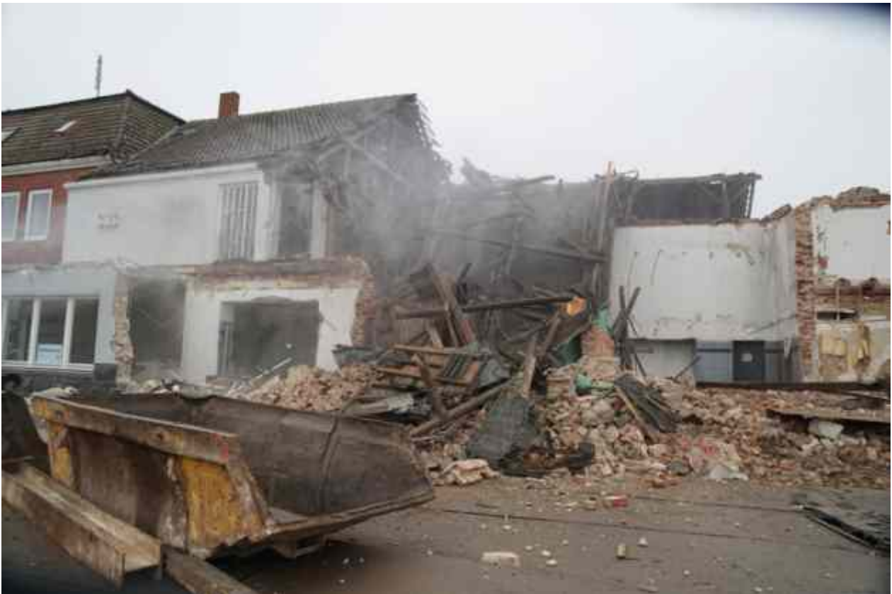
Der Mittelbau ist zerstört
